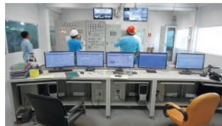
Leitstand einer Biomasseanlage
